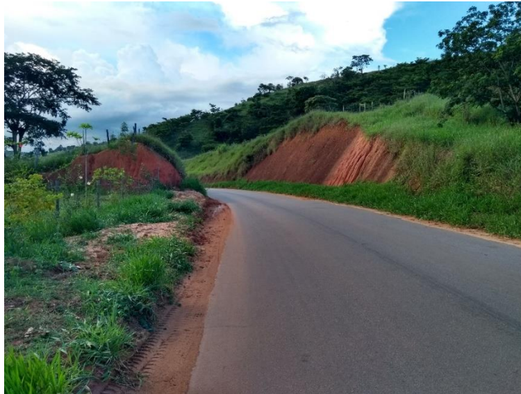
Figura 06 – Falta de canaleta e talude sem vegetação na MG-409.
