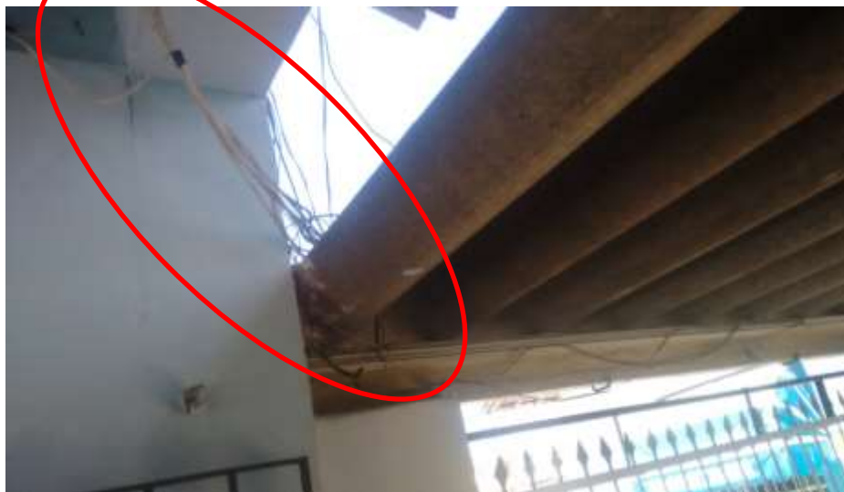
Figura 4 – Fiação de energia elétrica com emendas e exposta.
