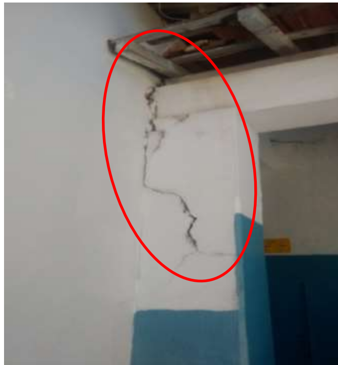
Figura 1 – Rachaduras e trincas no pilar e na viga.
