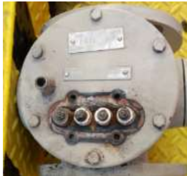
Figura 4. Relé Buchholz do transformador SUTF6-03 após o sinistro.
