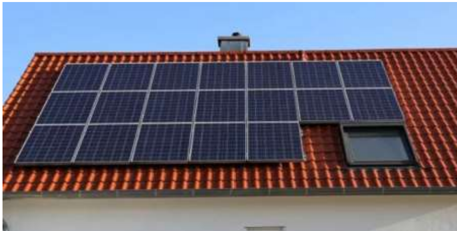
Figura 3 - Placa Fotovoltaica Residencial.
