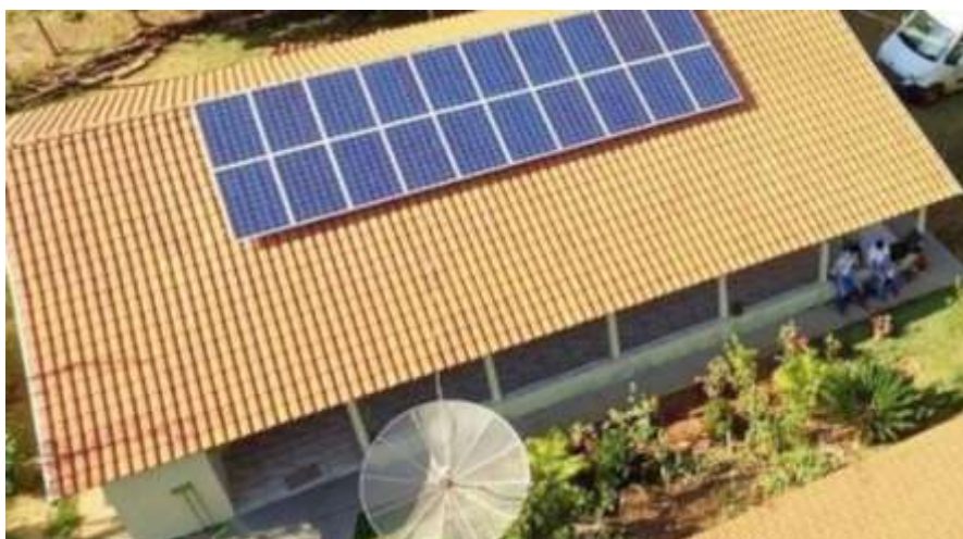
Figura 11 - Sistema Solar Fotovoltaico Isolado.
