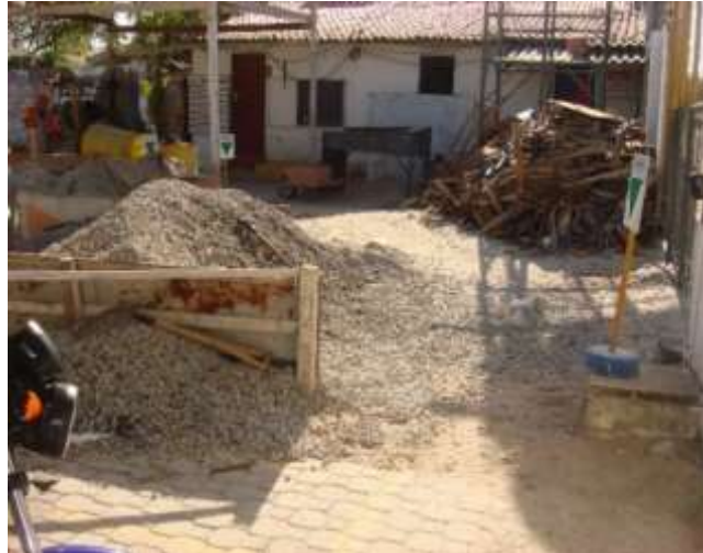
Figura 5 - Disposição inadequada de materiais de construção e resíduos.
