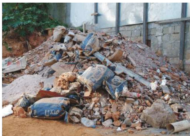
Figura 6 - Local com a disposição do entulho da obra sem sinalização e proteção contra acidentes e incidentes.
