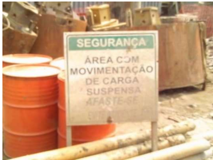
Figura 9 - Sinalização de alerta no trânsito e descrição do risco no canteiro de obras.
