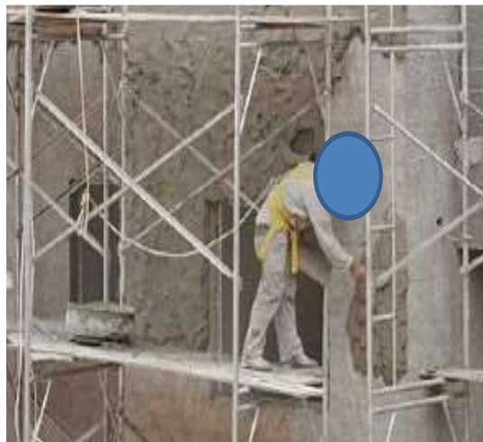
Figura 3 - Situação de risco do trabalho em altura no canteiro de obras visitado.
