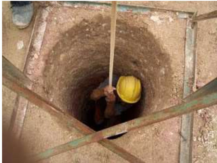
Figura 7 - Exemplo de trabalho realizado no canteiro de obras em condições parcialmente adequadas.
