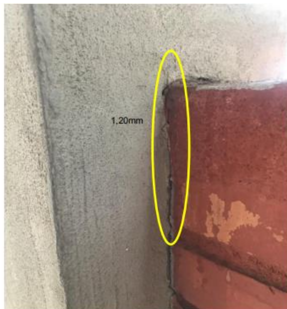
Figura 6 – Trinca entre alvenaria aparente e pilar - 3º Pavimento do Edifício 2
