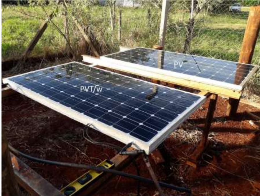
Figura 3. Placas PVT/w e PV instaladas para testes.
