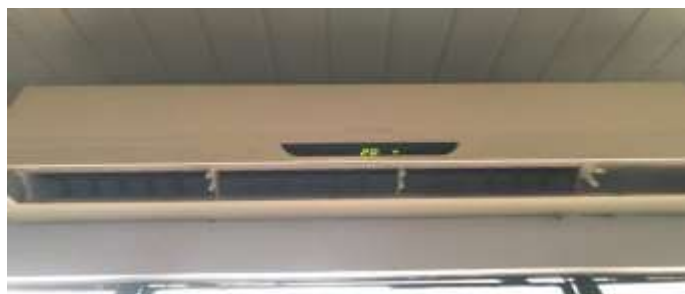
Figura 1 - Ar-condicionado instalado na Instituição.
