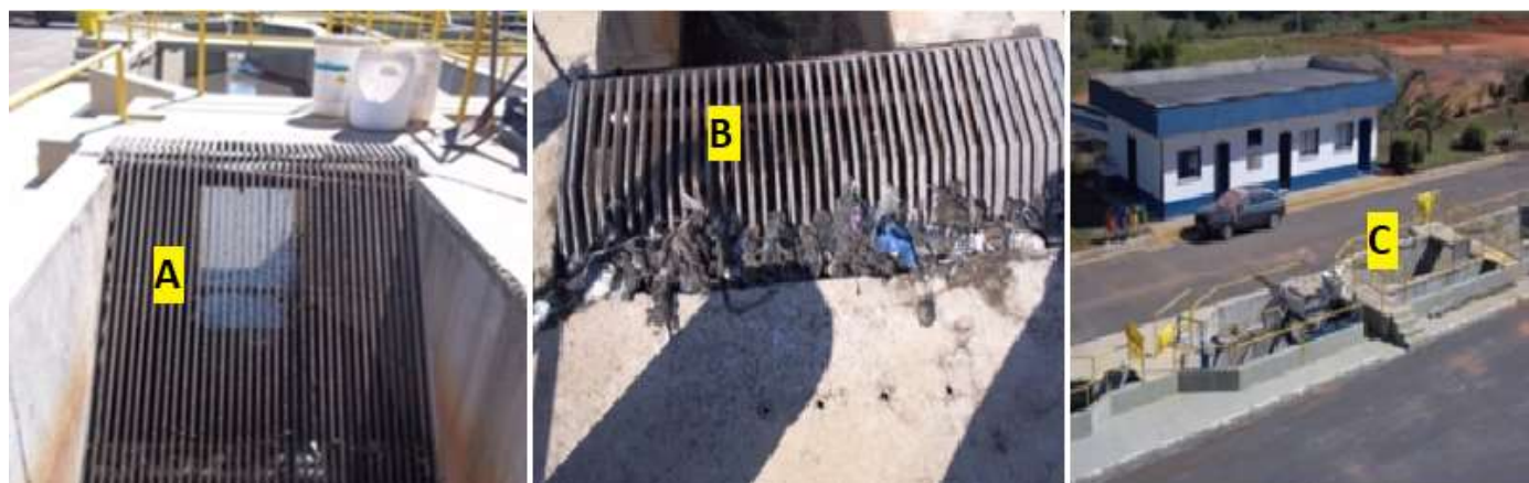
Figura 2 - Etapas de gradeamento: Respetivamente, grades de 6mm (A); material Separado (B); grades de 12 mm e desarenador (C).
