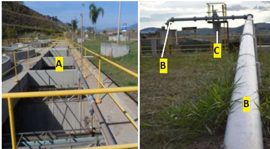
Figura 6 - Etapas da queima dos gases produzidos no tratamento de esgoto. Respectivamente, coifa do Reator UASB (A); linha de distribuição de gás produzido no Reator UASB (B); selo hídrico (Caixa com água para evitar explosão) (C).
