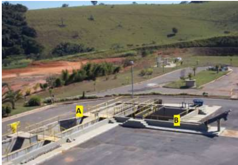
Figura 3- Calha Parshall (A) e Caixa de carvão ativado (B).
