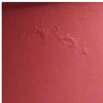
Figura 2 - Aparecimento de bolhas nas paredes.
