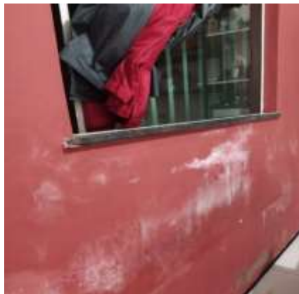
Figura 4 - Apresentação de saponificação nas paredes.
