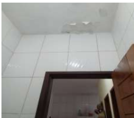
Figura 3 - Descascamento de tinta no banheiro da residência.
