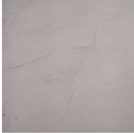
Figura 5 - fissuras mapeadas encontrada na residência.
