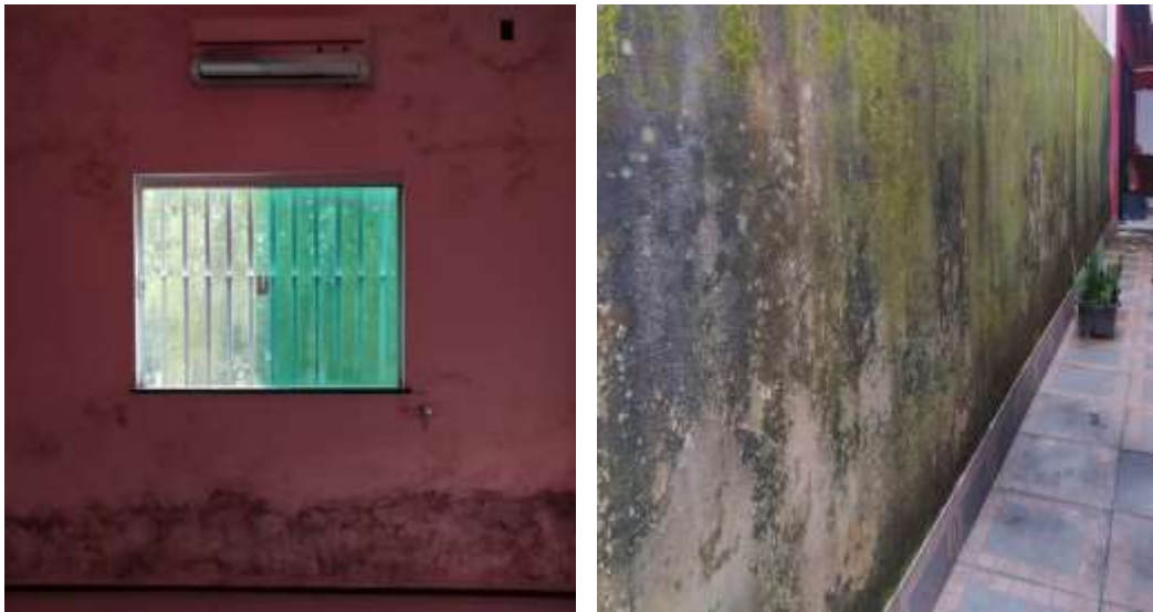
Figura 6 - (a) mofo na parte interna da casa; (b) mofo na parte externa da casa.
