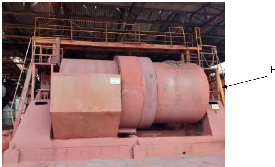
E- guarda corpo quebrado; F- cor original da plataforma. Fonte: Autoria própria
