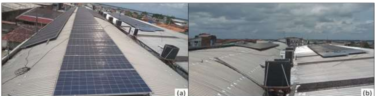
Figura 5. Módulos Fotovoltaicos instalados na edificação comercial em Belém, Pará.
