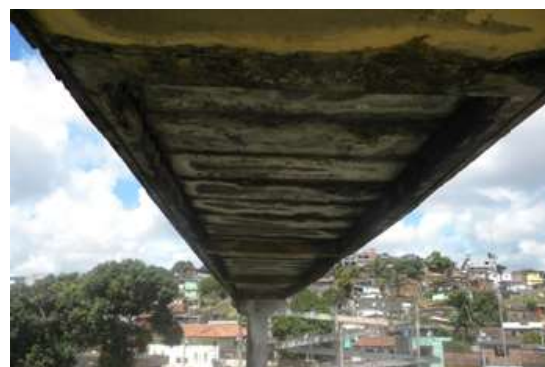
Figura 12. Manchas de umidade e eflorescências na face inferior do tabuleiro oriundas da deficiência do sistema de drenagem do tabuleiro.
