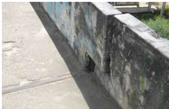
Figura 9. Detalhe da região do dente Gerber apresentando deslocamento lateral entre as estruturas do tabuleiro.
