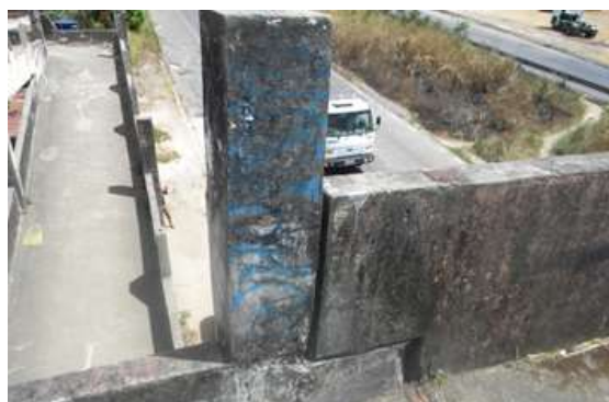
Figura 11. Detalhe da junta sobre dente Gerber com abertura excessiva na região do apoio, onde o concreto encontra-se deteriorado.
