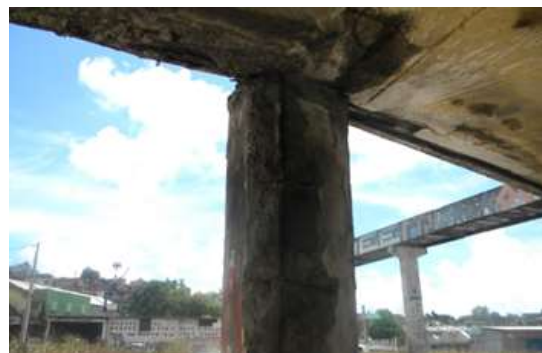
Figura 10. Ligação da laje do passeio com o pilar apresentando danos no concreto e perda de seção de armaduras transversais.
