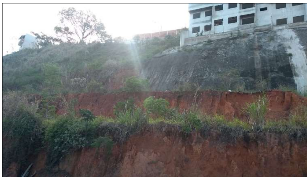
Figura 9: Muro grampeado que não tem função estrutural do solo.
