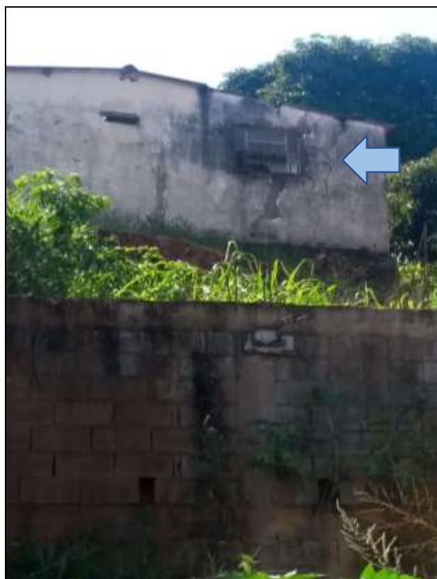
Figura 8: Trincas em residência localizada na Encosta.
