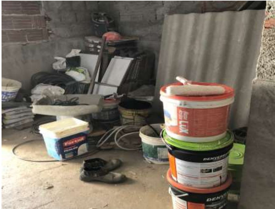
Figura 3 – Armazenagem de incorreta de materiais no canteiro analisado.
