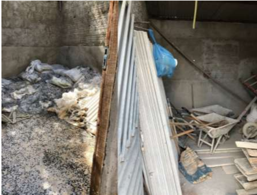
Figura 5 – Lixo e desorganização no almoxarifado no canteiro de obras da analisado.
