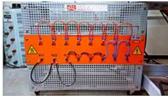
Figura 10 - Banco de resistores.
