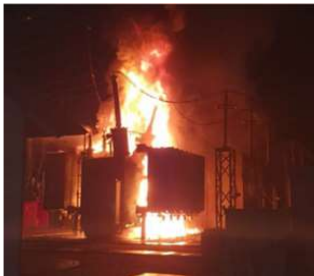
Figura 4 – Incêndio do TR1 da SE Macapá.
