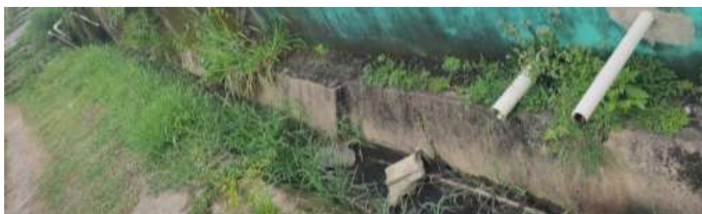
Figura 9 – Presença de vegetação, resíduos sólidos e descarte irregular de águas cinzas.
