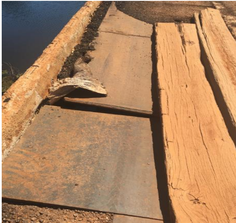
Figura 6 – Improvisos na substituição dos tabuleiros danificados.
