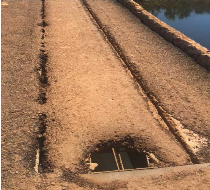
Figura 5 – Tabuleiros danificados e armaduras expostas.
