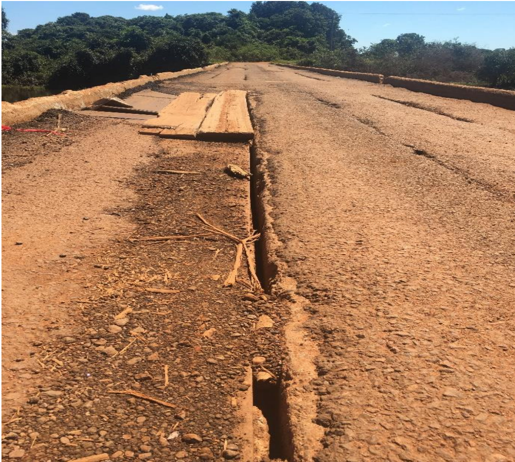
Figura 4 – Ponte danificada sobre o Rio Urubu.
