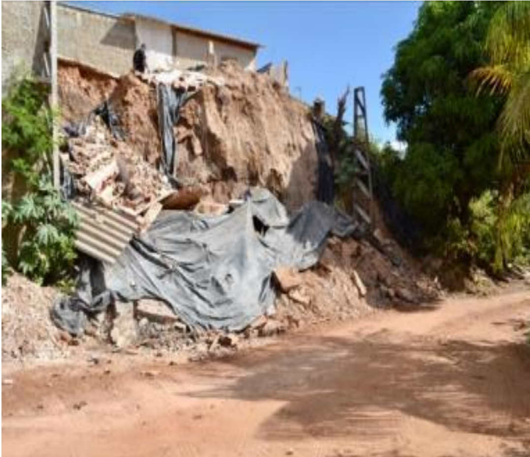
Figura 3 – Muro de contenção colapsado.
