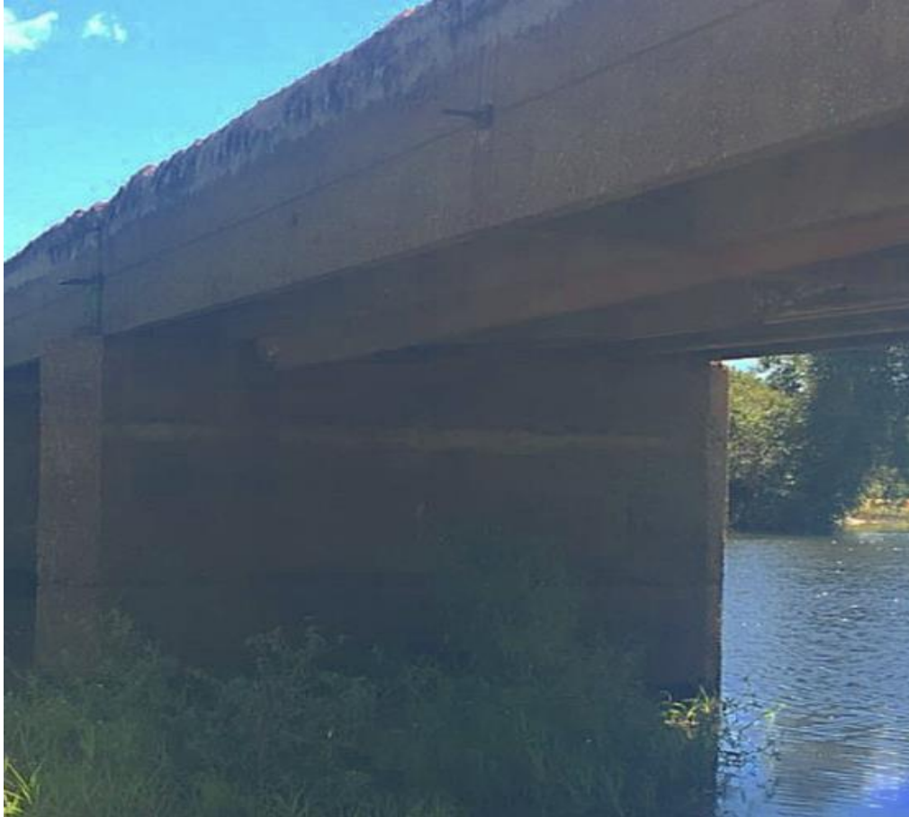
Figura 7 – Vigas deslocadas e armaduras expostas.
