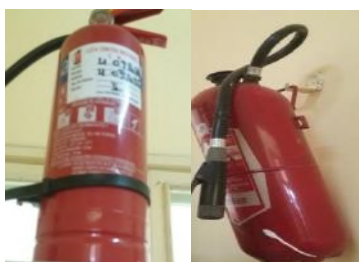
Figura 1: Extintores de incêndio
