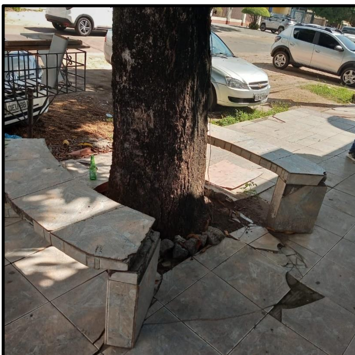
Figura 6 – Árvore quebrando o calçamento.
