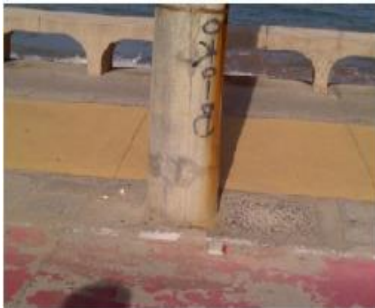
Figura 3 - Corrosão em poste de concreto armado na orla de Olinda-PE.
