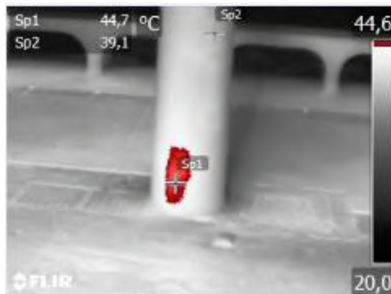
Figura 9 - Termograma – Poste 09 – Análise do fluxo de calor.
