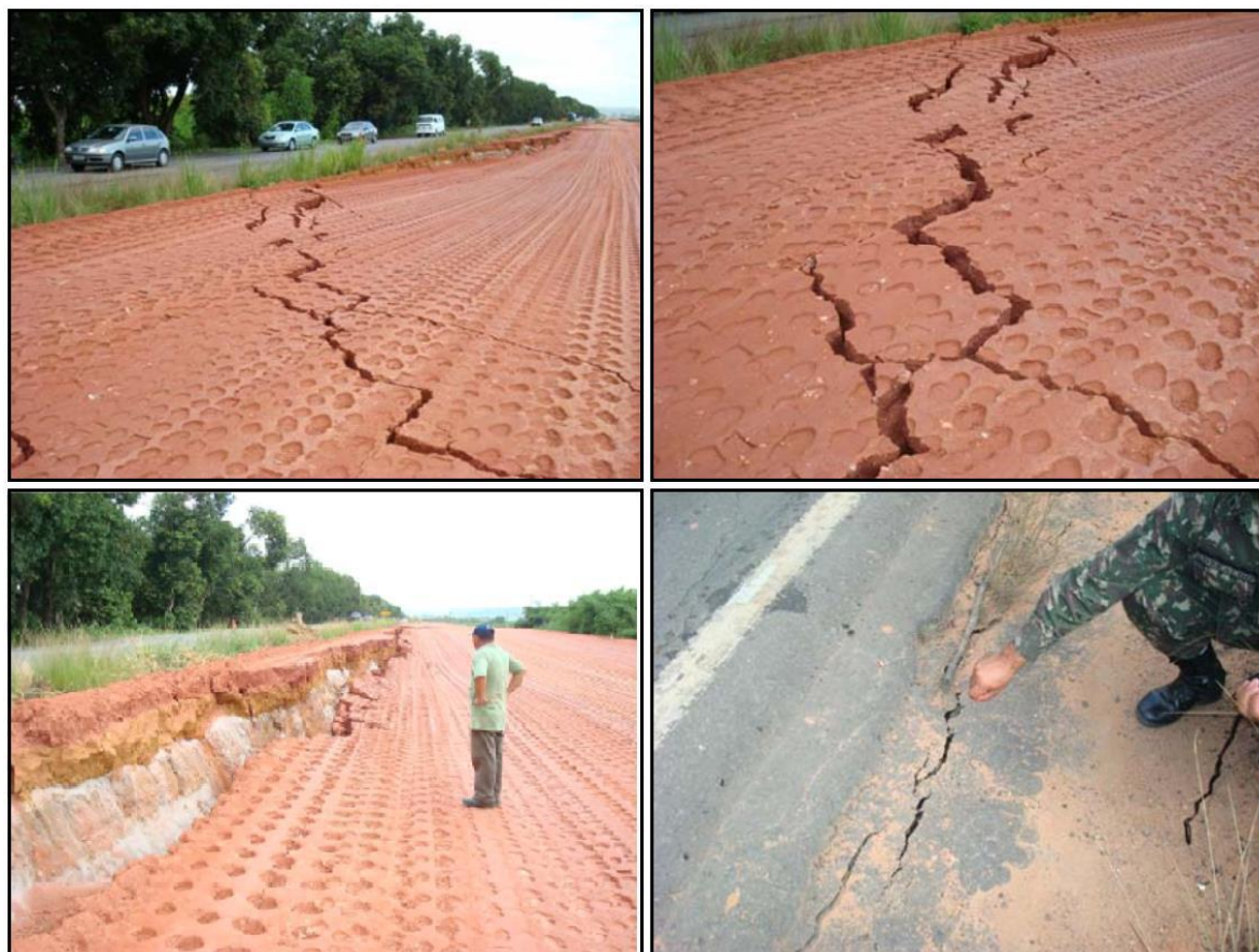
Figura 3 – Ruptura do aterro 5 – Segmento de aproximadamente 160 metros.
