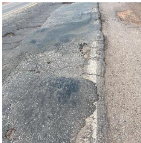
Figura 8: Remendo encontrado no pavimento.
