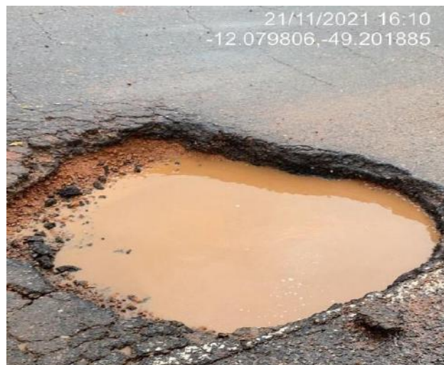
Figura 4: Panela ou buraco.
