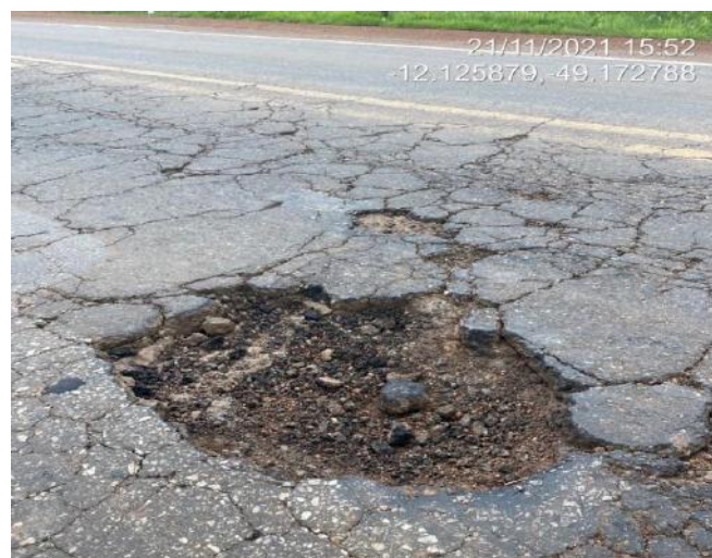
Figura 5: Panela ou buraco.
