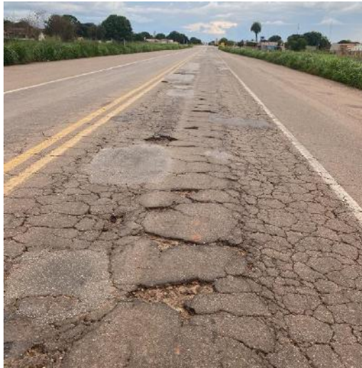
Figura 6: Trinca tipo Couro de Jacaré.
