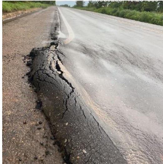
Figura 7: Escoamento do revestimento.
