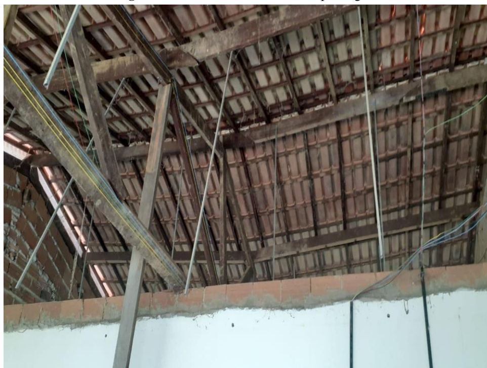
Figura 3 - Estrutura em madeira com patologias.
