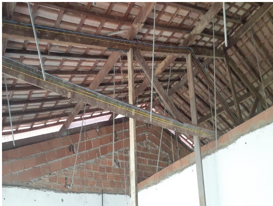
Figura 2 - Estrutura em madeira antiga e desgastada.
