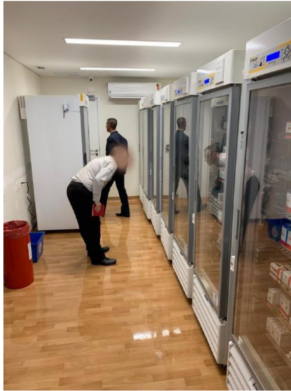
Figura 5: Exemplo sala de câmaras para conservação de vacina.
