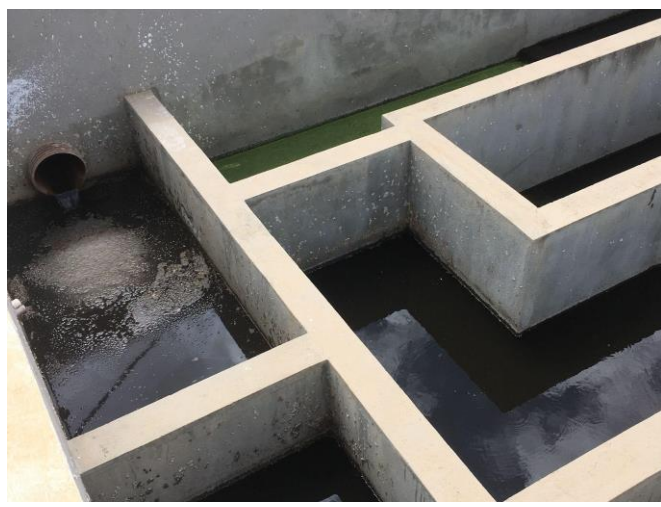
Figura 7: Entrada do tanque de cloração.
