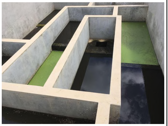
Figura 8: Saída do tanque de cloro (centro).
