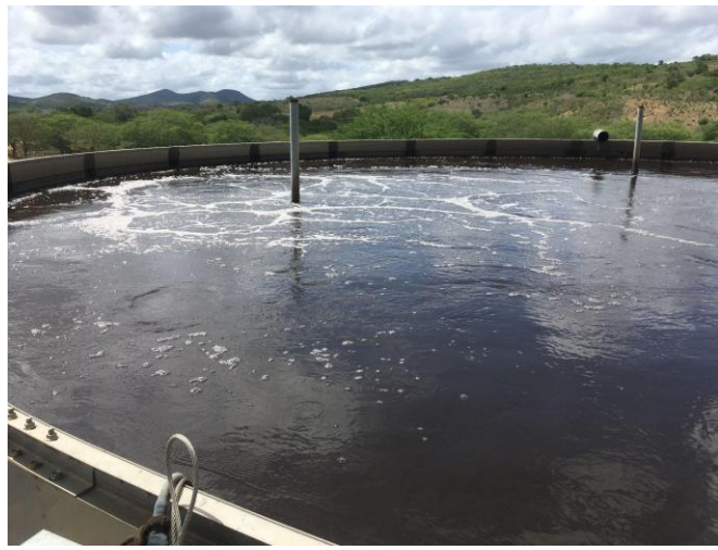
Figura 5: Tanque de Aeração.
