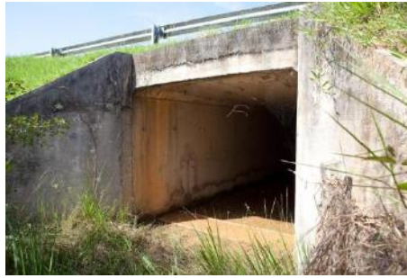
Figura 3 - Túnel para passagem da fauna.
