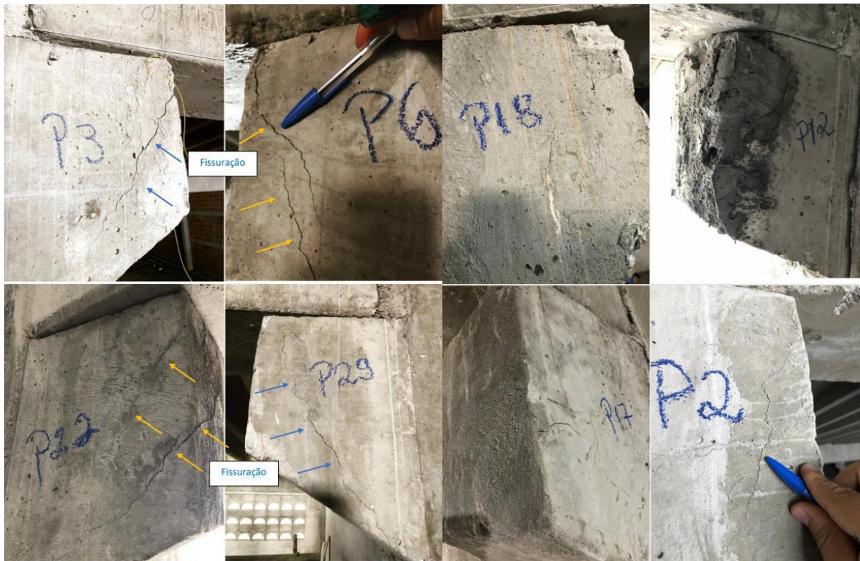
Figura 6 – Consolo de pilares com problemas.
