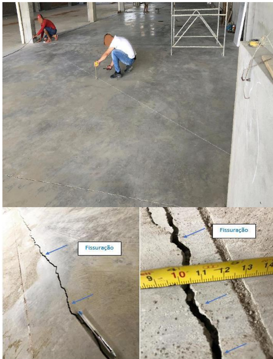
Figura 3 – Lajes com problemas de fissuração e deformação excessiva.
