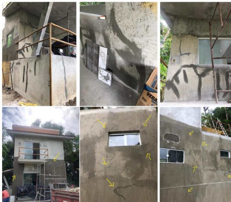
Figura 2 – Problemas de fissuração encontrados na área externa da residência.
