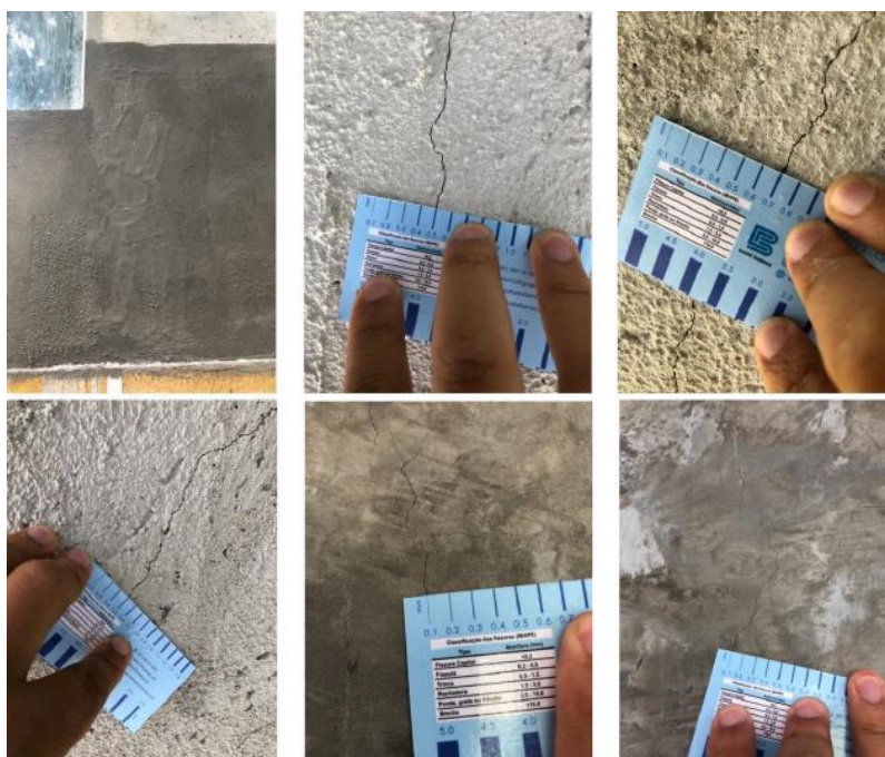
Figura 3 – Problemas de fissuração encontrados na área externa da residência.
