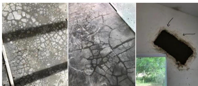
Figura 4 – Problemas de fissuração encontrados na área interna da residência.
