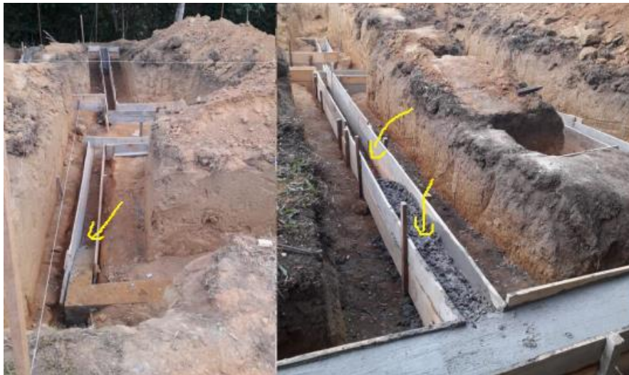
Figura 5 – Vigamento baldrame sem armaduras.
