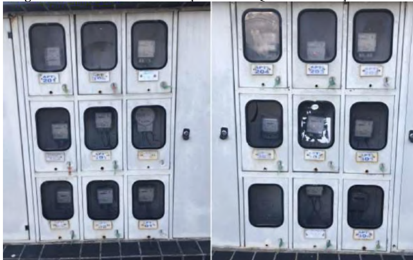
Figura 14 – Problemas na instalação elétrica. Quadro de Medição Externo.
