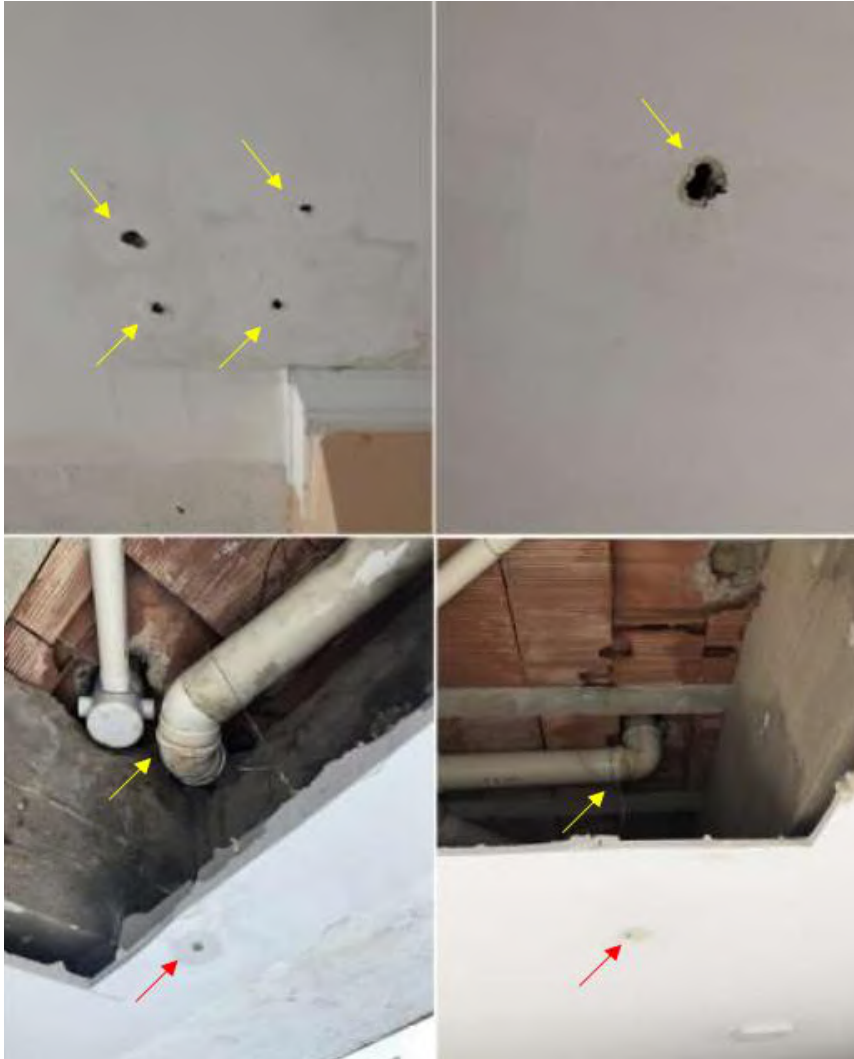
Figura 4 – Forro de gesso danificado no pavimento semienterrado.
