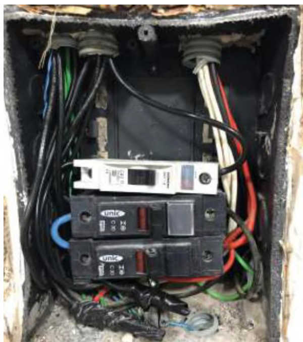
Figura 16 – Disjuntores insuficientes para toda instalação.
