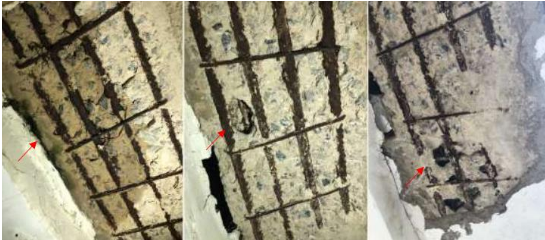
Figura 5 – Viga danificada no pavimento semienterrado.
