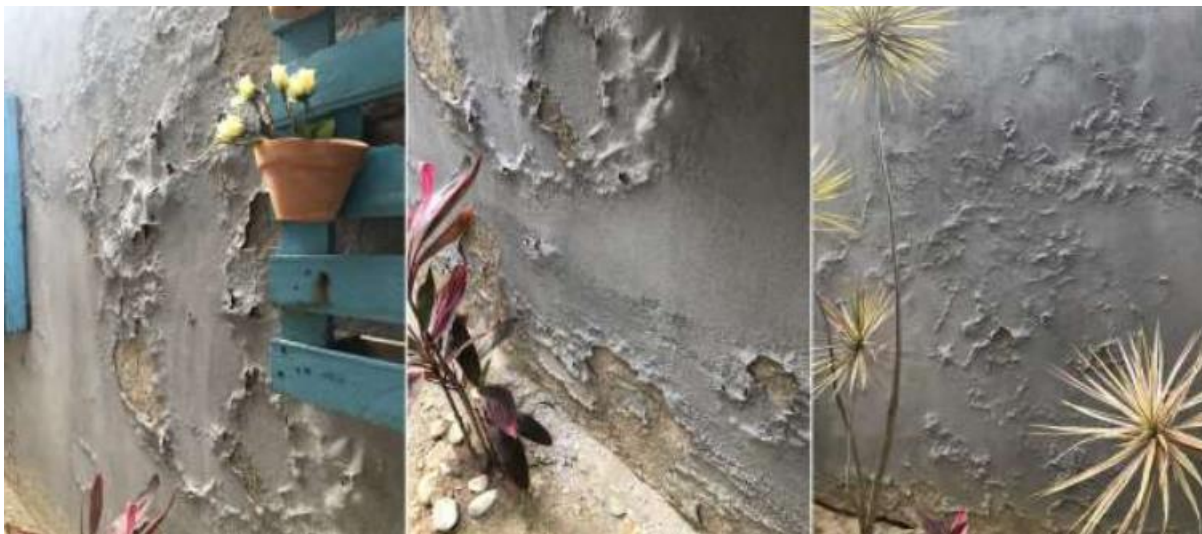
Figura 8 – Contenção com problema de degradação do revestimento por umidade.
