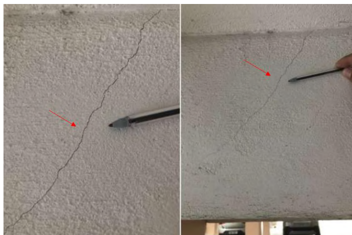
Figura 6 – Viga com problema de cisalhamento.
