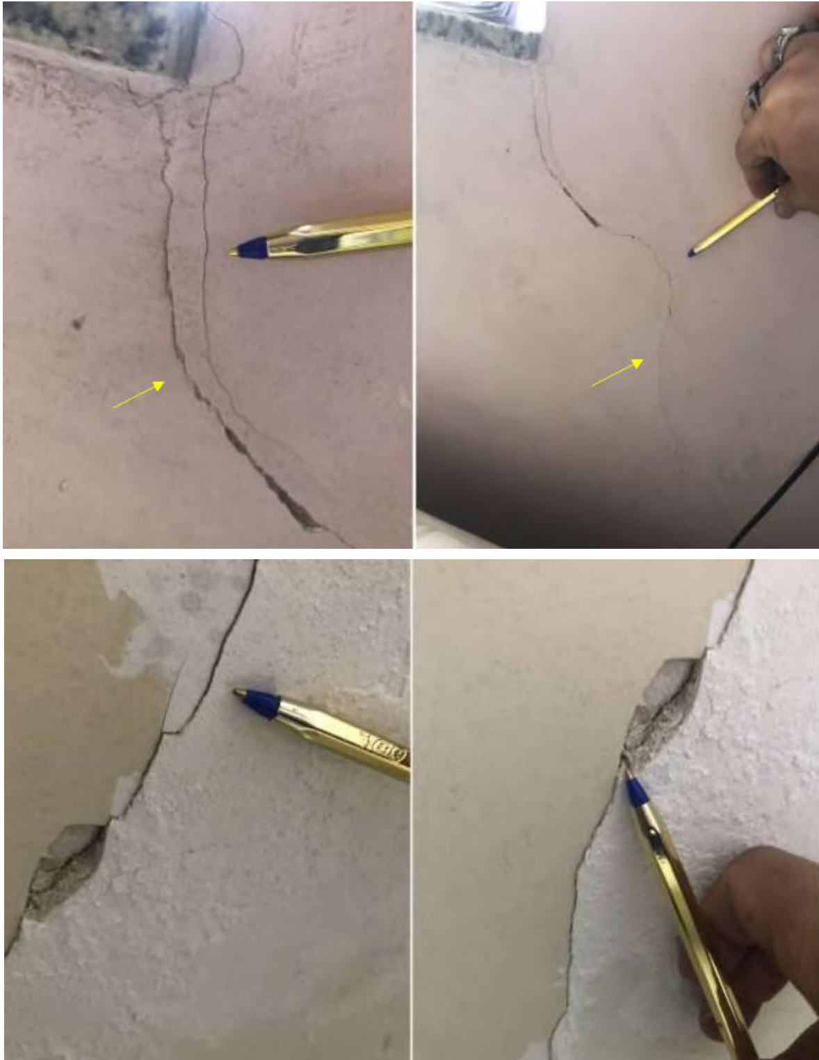
Figura 11 – Fissuras em painéis de alvenaria nos apartamentos.
