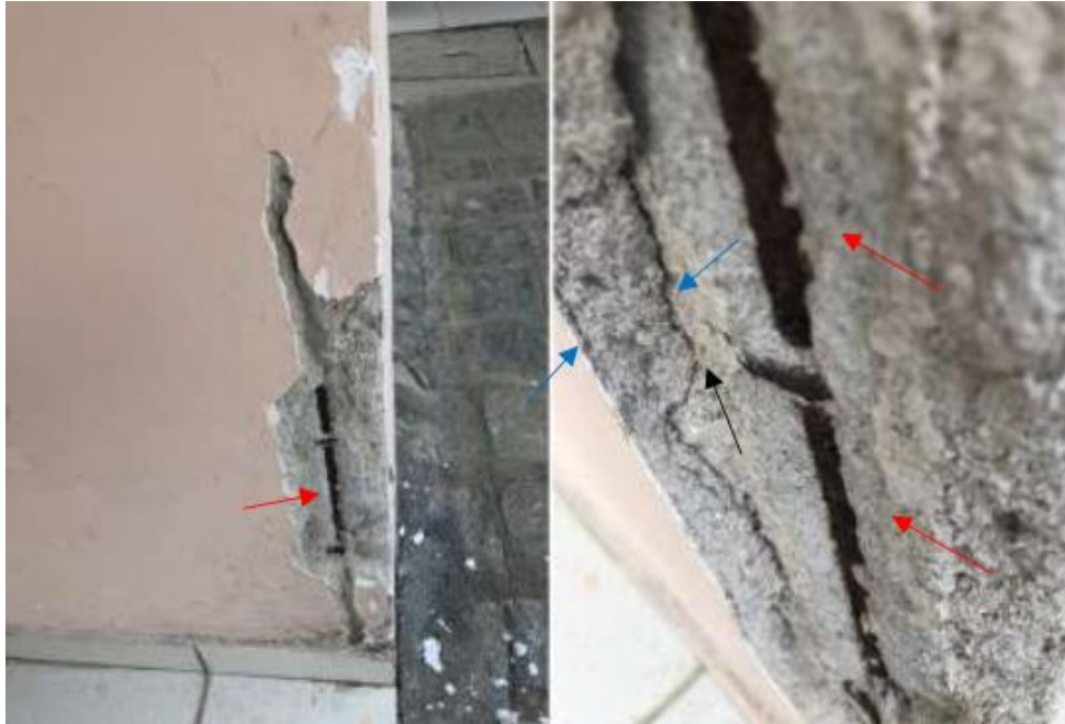
Figura 9 – Pilar com armadura apresentado problema de corrosão.
