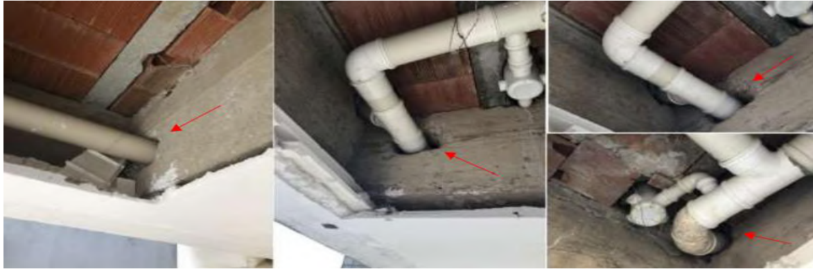
Figura 7 – Viga com furo inadequado.
