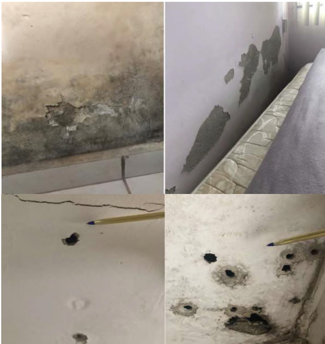
Figura 13 – Problemas de infiltração.
