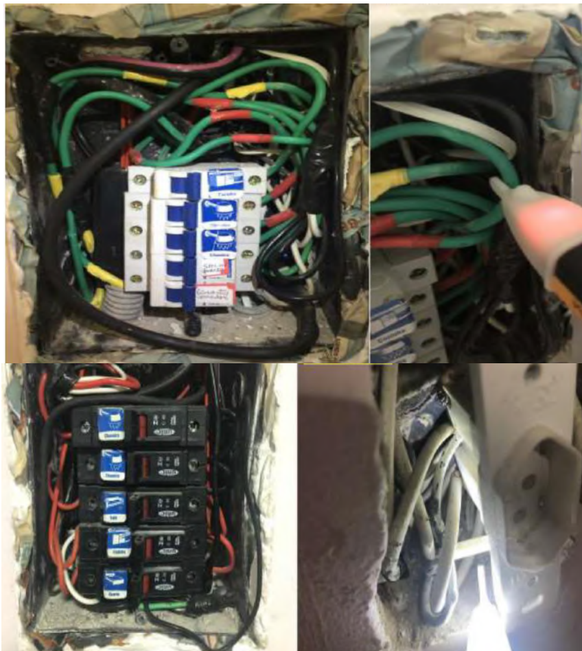
Figura 15 – Fiação com cores inadequadas.
