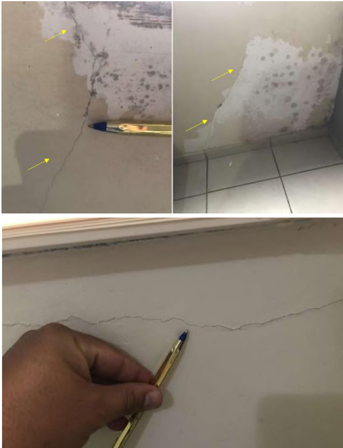
Figura 12 – Fissuras em painéis de alvenaria nos apartamentos.
