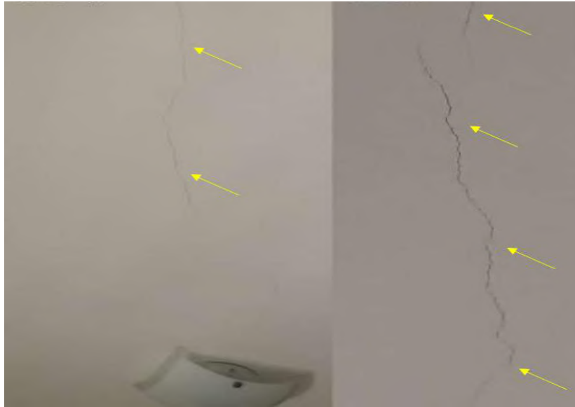
Figura 10 – Fissuras em lajes dos apartamentos.
