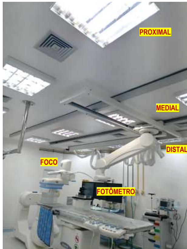
Figura 1. Conjunto de luminárias da sala de Hemodinâmica.
