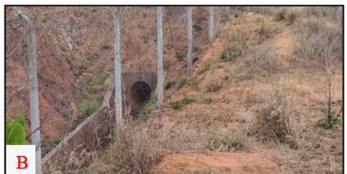
B) Canal de drenagem que termina no canal erodido.
