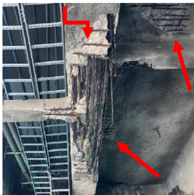
Figura 3. Situação de viga, com armadura exposta, localizada na parte de baixo da ponte Santa Isabel – 2022.
