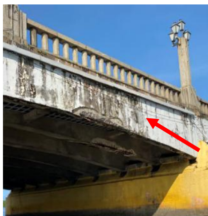
Figura 2: Presença de Bolor na fachada da Ponte Santa Isabel.
