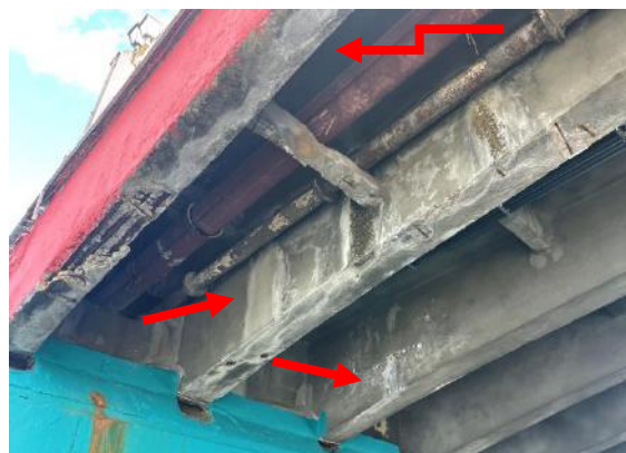
Figura 5B: Eflorescência na parte inferior da ponte Santa Isabel.
