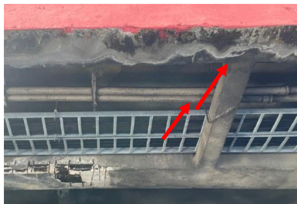
Figura 6B: Aparecimento de manchas de umidade na parte inferior da ponte Santa Isabel.
