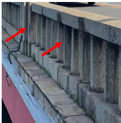
Figura 7A: Sujidade na fachada da ponte Santa Isabel.
