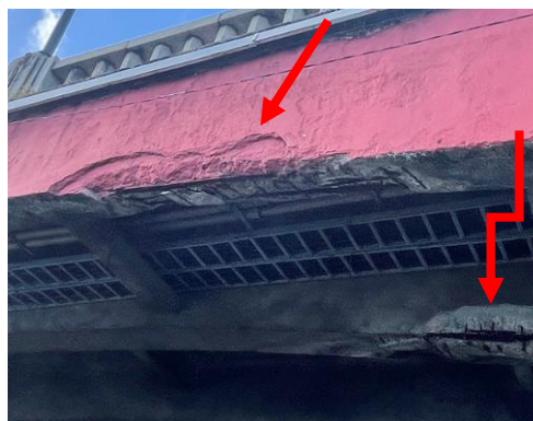
Figura 4B: Desagregação de material presente na fachada e na parte inferior da Ponte Santa Isabel, 2022.
