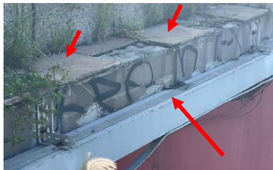
Figura 7B: Vandalismo, presença de vegetação e deslocamento de pedra ornamental na fachada da ponte.
