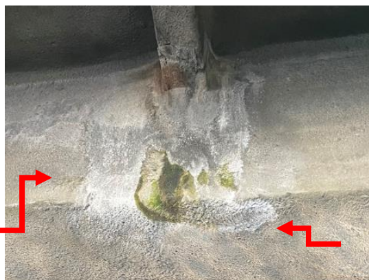
Figura 5A: Eflorescência na parte inferior da ponte Santa Isabel.
