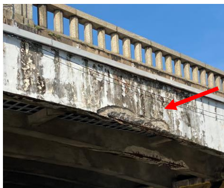
Figura 4A: Desagregação de material presente na fachada e na parte inferior da Ponte Santa Isabel, 2021.
