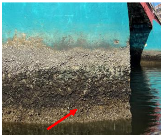
Figura 6A: Incrustação observada na base da ponte Santa Isabel.
