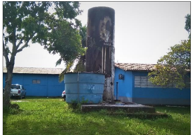
Figura 8: Poço de Captação de Água.
