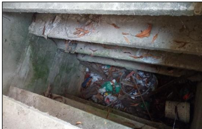
Figura 2. Jazigo aberto com resíduos sólidos no interior.
