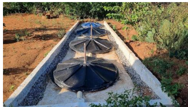
Figura 6 – Sistema de fossa biodigestora em operação.
