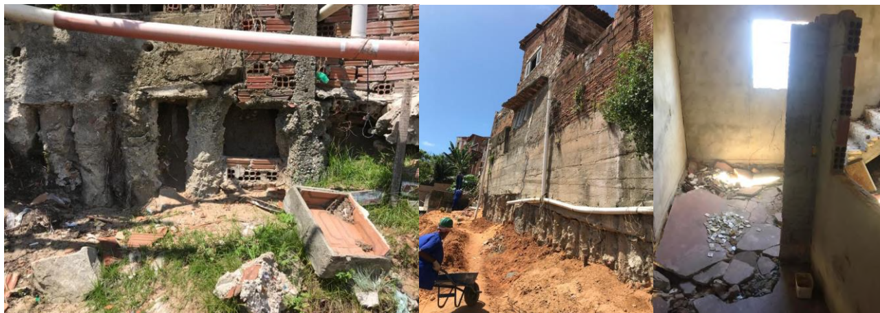
Figura 8 - Avarias em contenção e residência Área 2.
