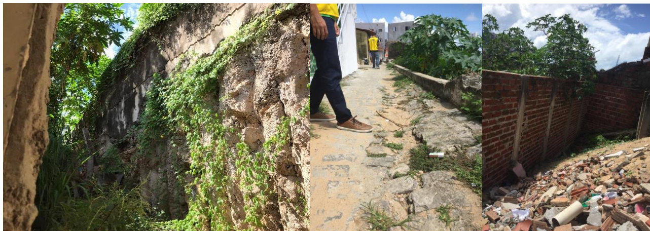
Figura 10 - Avarias em contenções Área 3.
