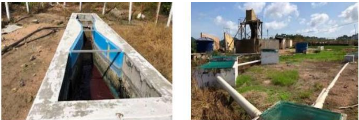
Figura 4 - Instalação de calha Parshall e caixas de gordura com proteção de tela.
