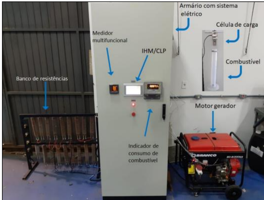
Figura 9 - Equipamentos utilizados no teste de eficiência de geração de energia.
