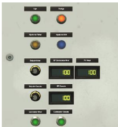
Figura 2 - Painel elétrico desenvolvido para o sistema de nível.
