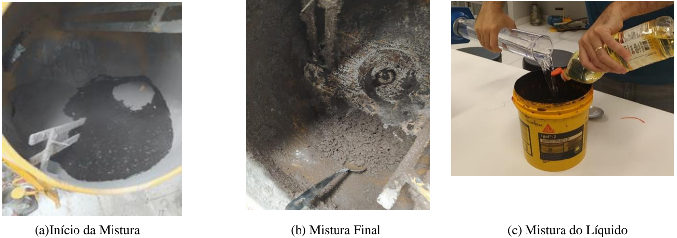
Figura 5 - Mistura asfáltica sendo adicionada a betoneira com mistura do líquido e o resultado.
