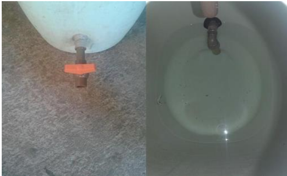
Figura 2- Válvula de efluente, vista externa / interna.
