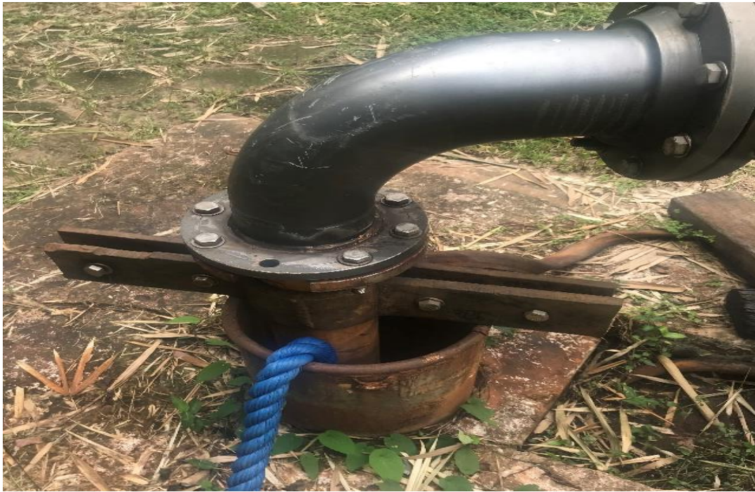
Figura 8 - Vista parcial da boca do poço artesiano.
