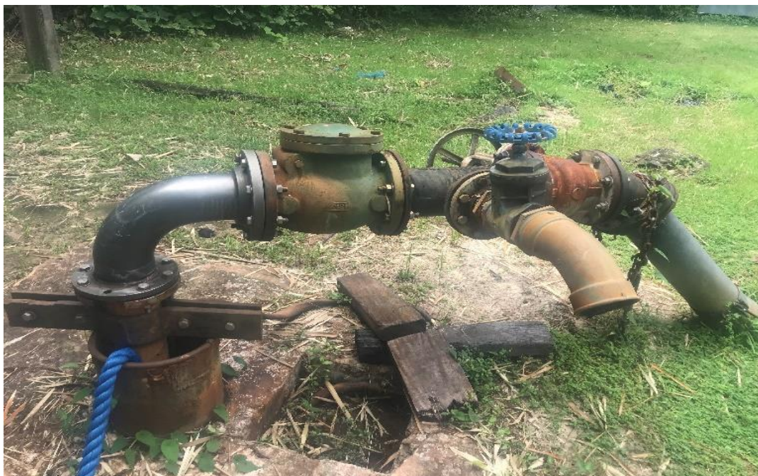
Figura 7- Vista geral do poço artesiano em funcionamento no Campus Sede da UFPA.
