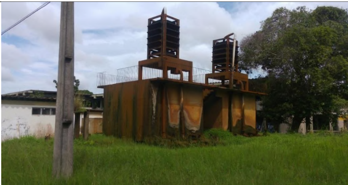
Figura 6 - Vista parcial da estação de tratamento de água da cidade Universitária.
