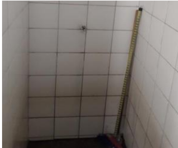
Figura 14: Vazamento na válvula do registro.
