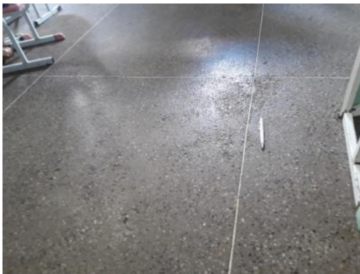
Figura 7: Piso industrial desgastado.
