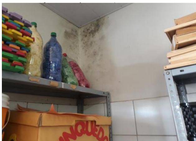
Figura 8: Infiltração e formação de bolor em sala de aula.
