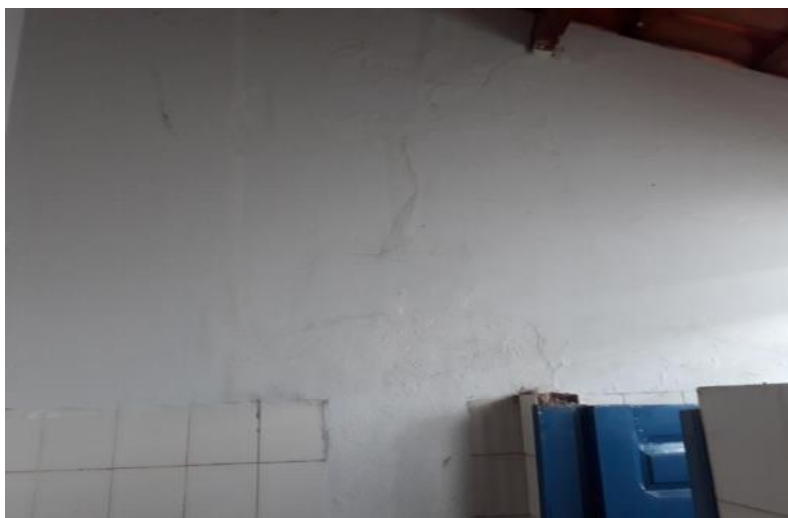
Figura 12: Manifestação de manchas e trinca.
