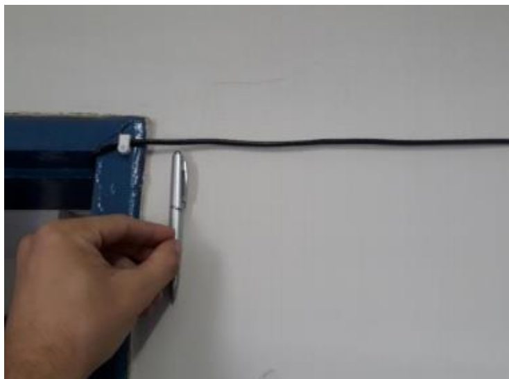
Figura 6: Patologias em entrada sala de coordenação.
