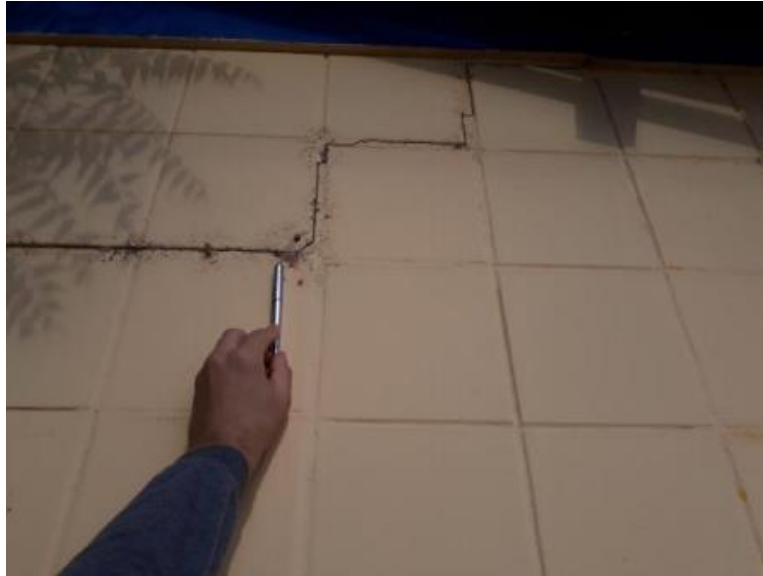
Figura 4: Trinca relacionada à carga concentrada advinda da linha.
