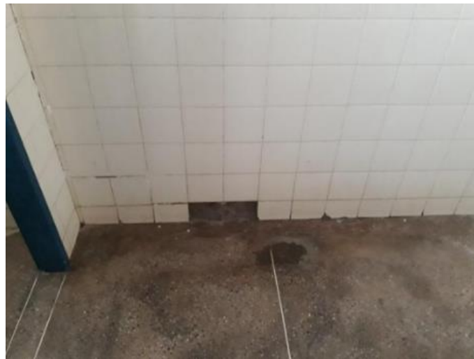
Figura 13: Trincas, infiltração e deslocamento cerâmico.
