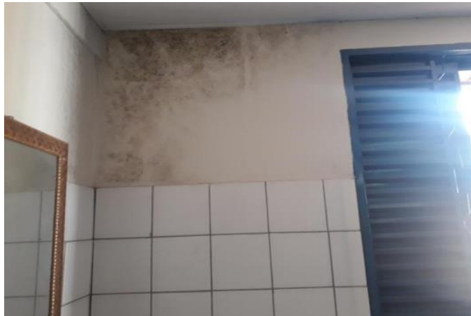
Figura 9: Infiltração e formação de bolor em sala de aula.
