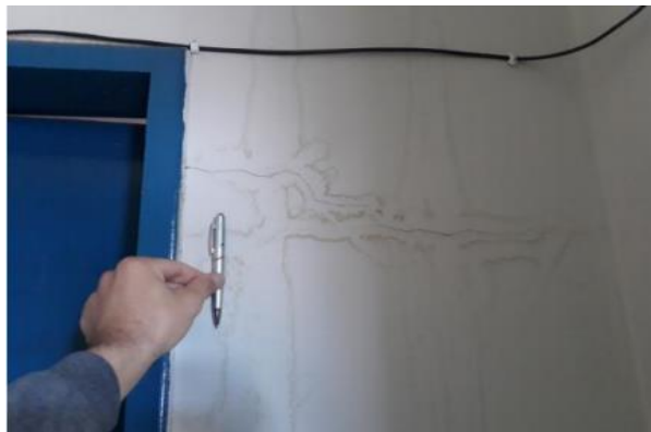
Figura 11: Manifestação de manchas e trinca.
