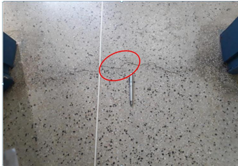
Figura 5: Trinca de 1mm na entrada da coordenação da escola.
