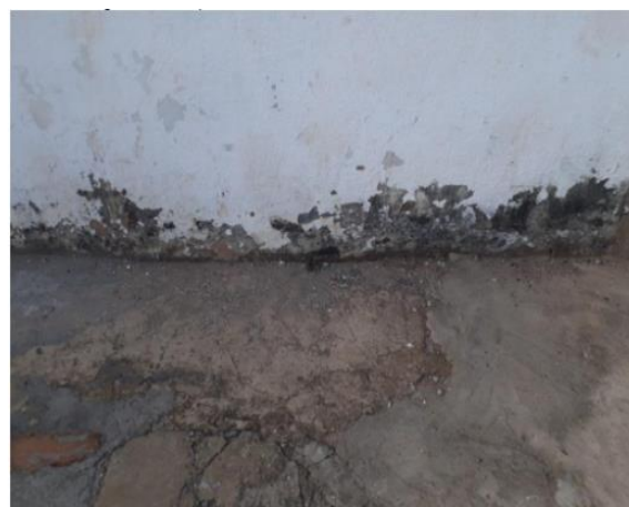
Figura 16: Patologia no Muro da escola.
