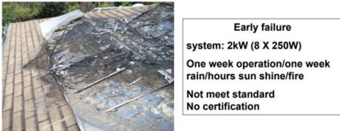
Figura 9 - Incêndio em Placas Solares FV por arco elétrico.
