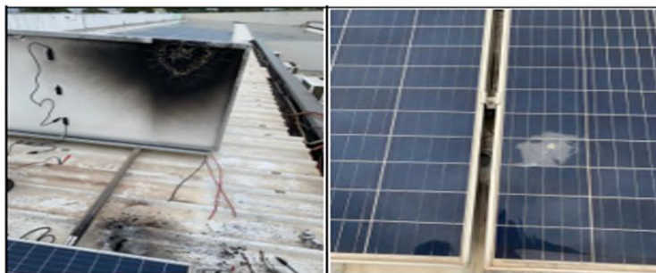
Figura 7 - Incêndio em Placas Solares FV por arco elétrico.
