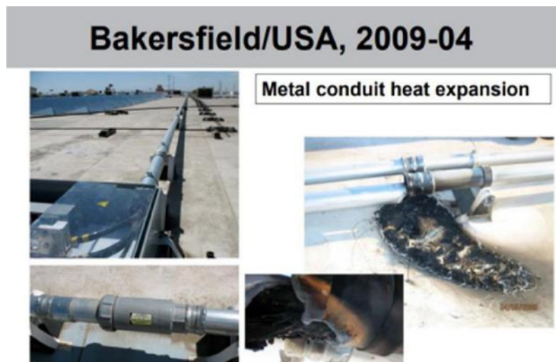
Figura 10 - Arco no conduíte de metal devido a isolamento dos cabos.
