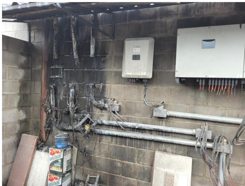
Figura 8 - Incêndio em sistema de energia solar.
