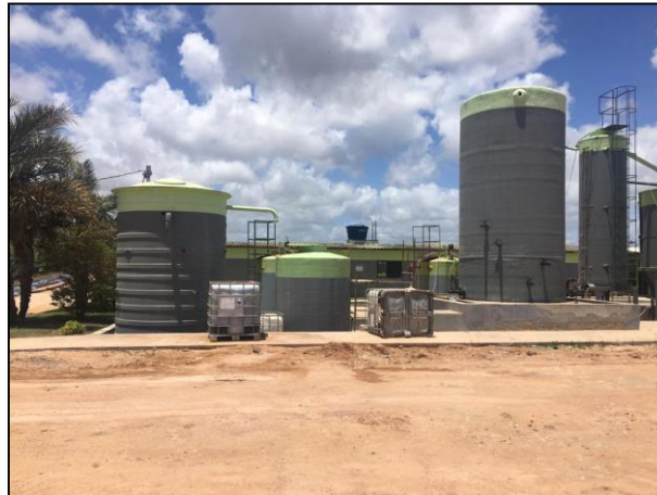
Figura 5 - Etapa físico-química da ETE do Aterro Sanitário de Maceió.
