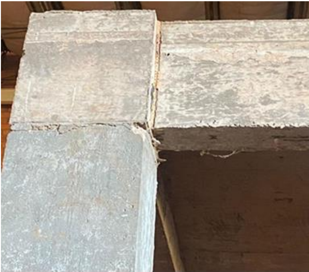
Figura 3 – Fissura em pilar.
