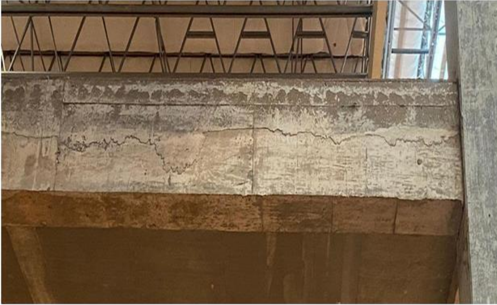
Figura 2 – Fissuras em vigas.
