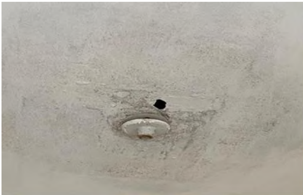
Figura 5 – Manchas de infiltração.
