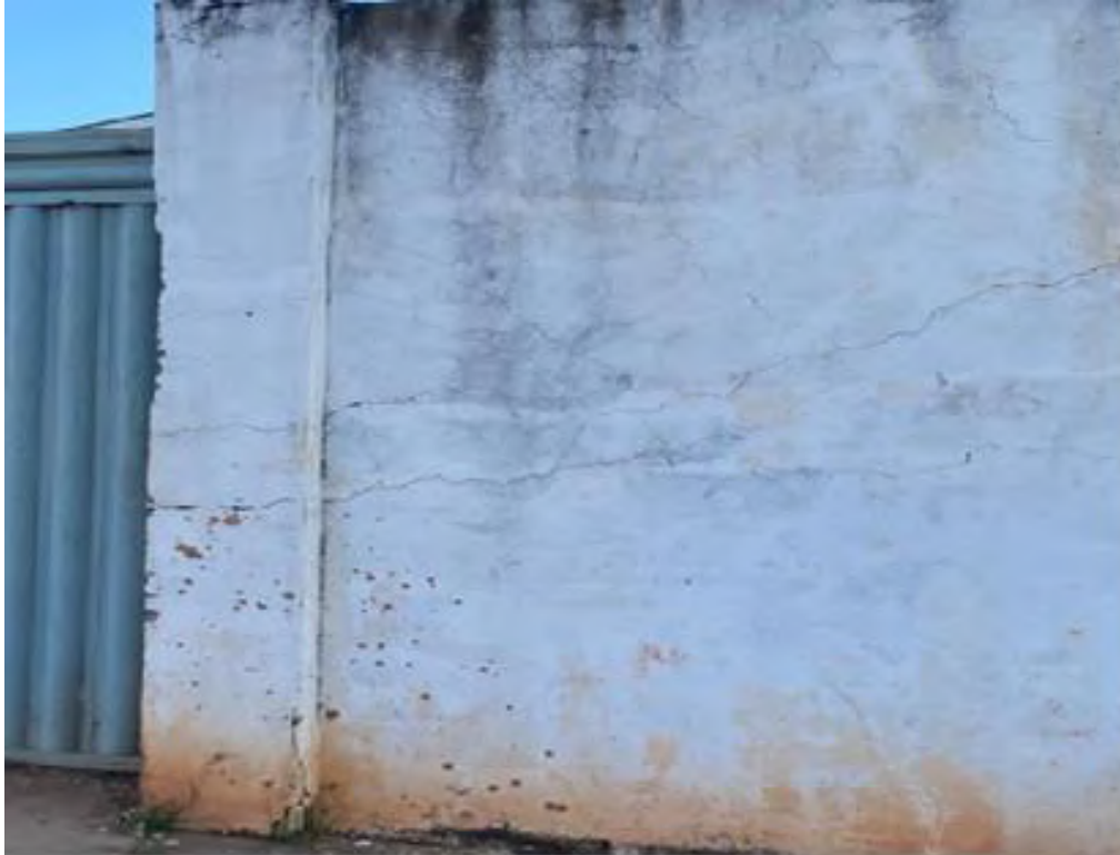
Figura 4 – Fissuras na parede.
