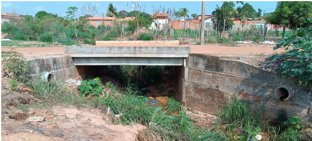
Figura 6 – Falta de segurança e lixo em baixo do pontilhão.
