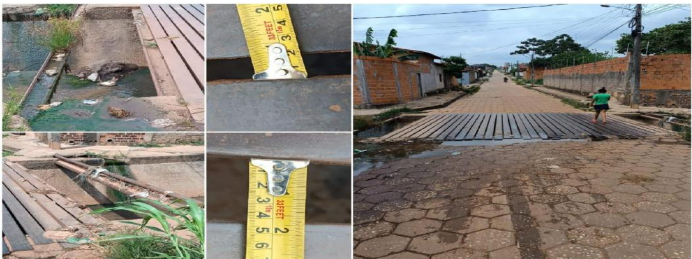
Figura 4 – Manifestações patológicas e presença de vegetação no segundo pontilhão metálico.
