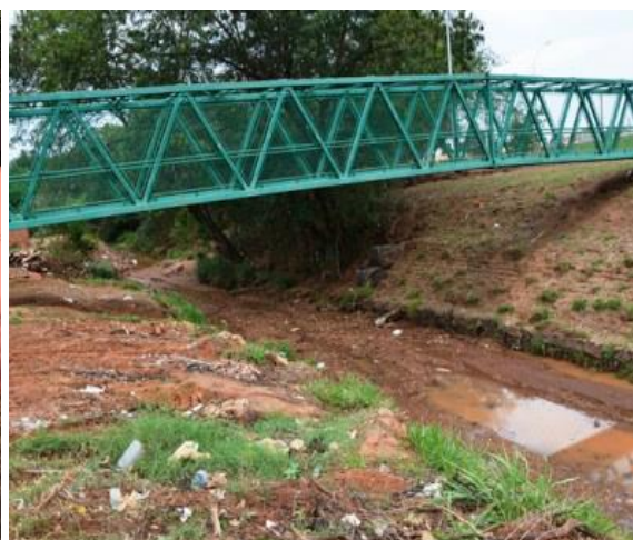
Figura 4: Córrego da onça, assoreado.
